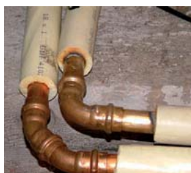
⊖ Wie gewonnen, so zerronnen: Schlechte Dämmung führt zu Wärmeverlusten.
