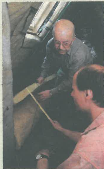
Die Wärmedämmung lohnt sich. Wer jetzt aktiv wird, kann sogar noch Fördergelder vom Klimaschutzfonds proKlima in Anspruch nehmen. Foto: Frick
