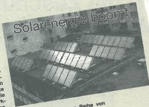
Eines von einer ganzen Reihe von Projekten in Hannover: die Solarthermianlage auf dem Hotel am Funkturm. Foto: Rathmann
