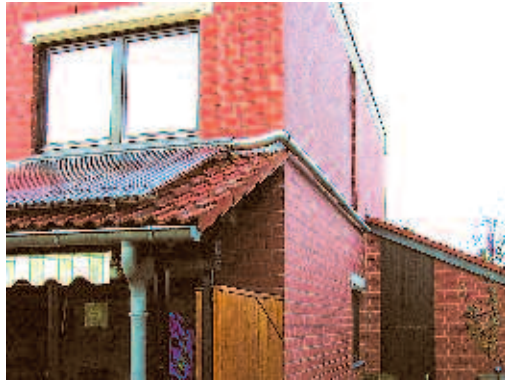
Hochwertig installierte Solarwärmanlage, Hemmingen
