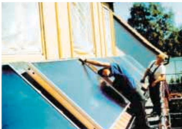
Solar Kollektoren, Slevogtweg, 2002
