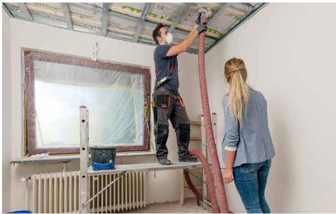
Einblasdämmung: Über einen Schlauch bläst ein Handwerker die Zellulose in die Zwischenräume in der Decke
